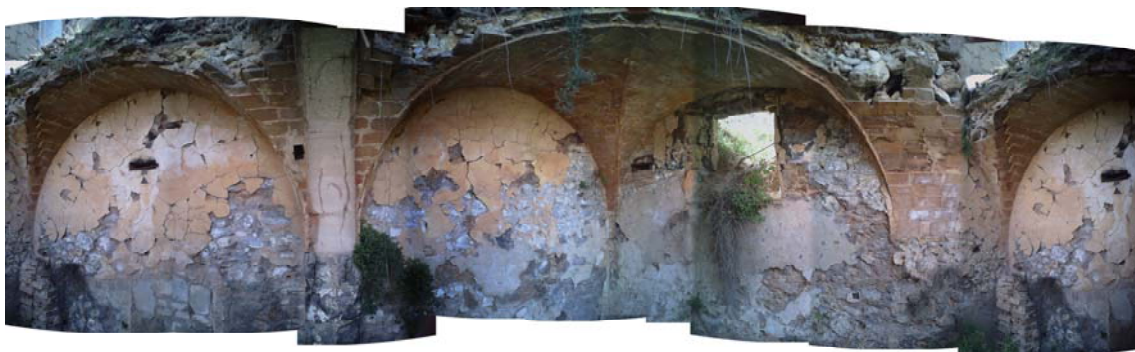
Figura 6.28. Detalle de una bóveda tabicada en ruinas, de la fábrica de primer agua de Soler Hermanos, barranco del Molinar, Alcoy. Imagen tomada en abril de 2013.
