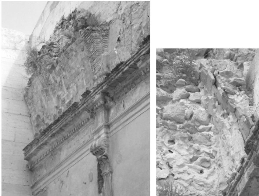
Figura 1.17: Cartuja de Valldescrist, en Altura (Castellón). A la izquierda, bóveda de la iglesia mayor, en ruinas, de ladrillo tabicado entre arcos fajones de rosca. A la derecha, detalle del arranque de la bóveda, en el que se ve que está formada por dos hojas y rellena por encima con cascotes y mortero.
