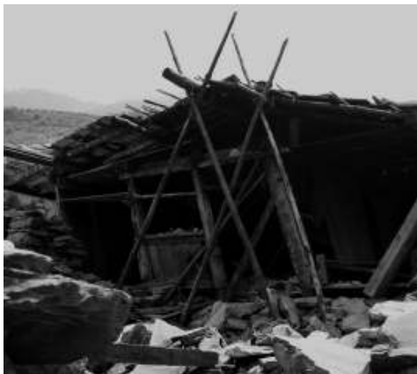
Figura 12 Foto de una vivienda dañada por el sismo del 2015 (Cedida por Beatriz López-Terradas)
